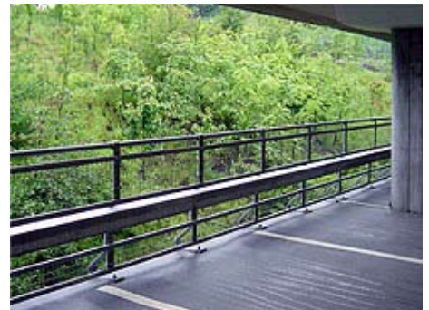
Ein System aus Anprallschutz und Absturzsicherung bilden den Gebäudeabschluss
